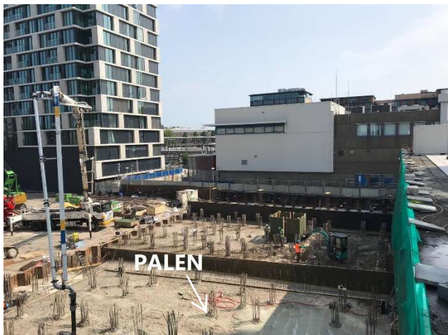
Afbeelding 2: Veel palen zijn al gereed. Het staal (wapening) vanuit de palen steekt omhoog en zal zorgen voor een verbinding met de fundering (grote blokken beton met staal er in).
